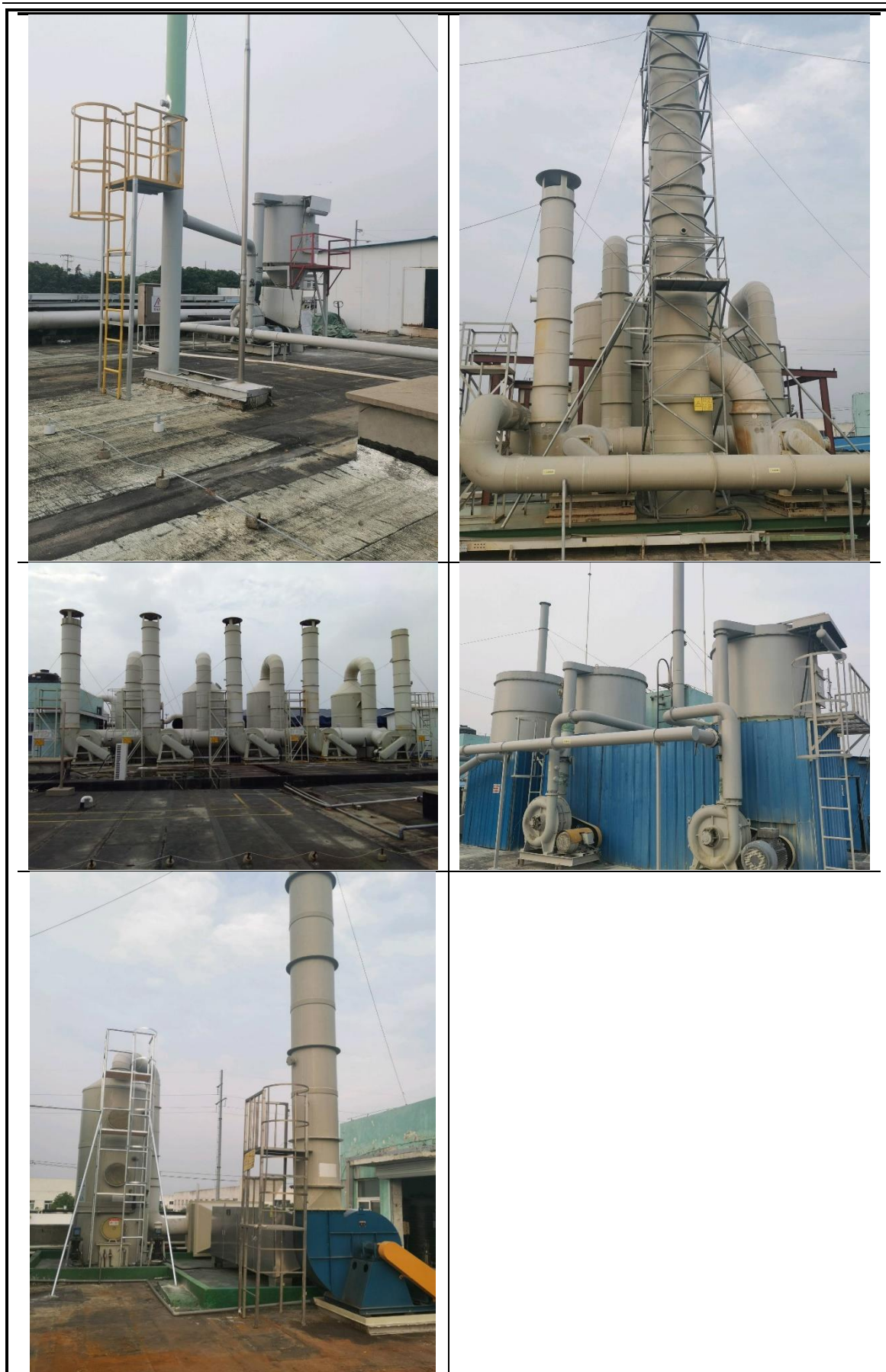
图 4-2 废气排气筒照片
